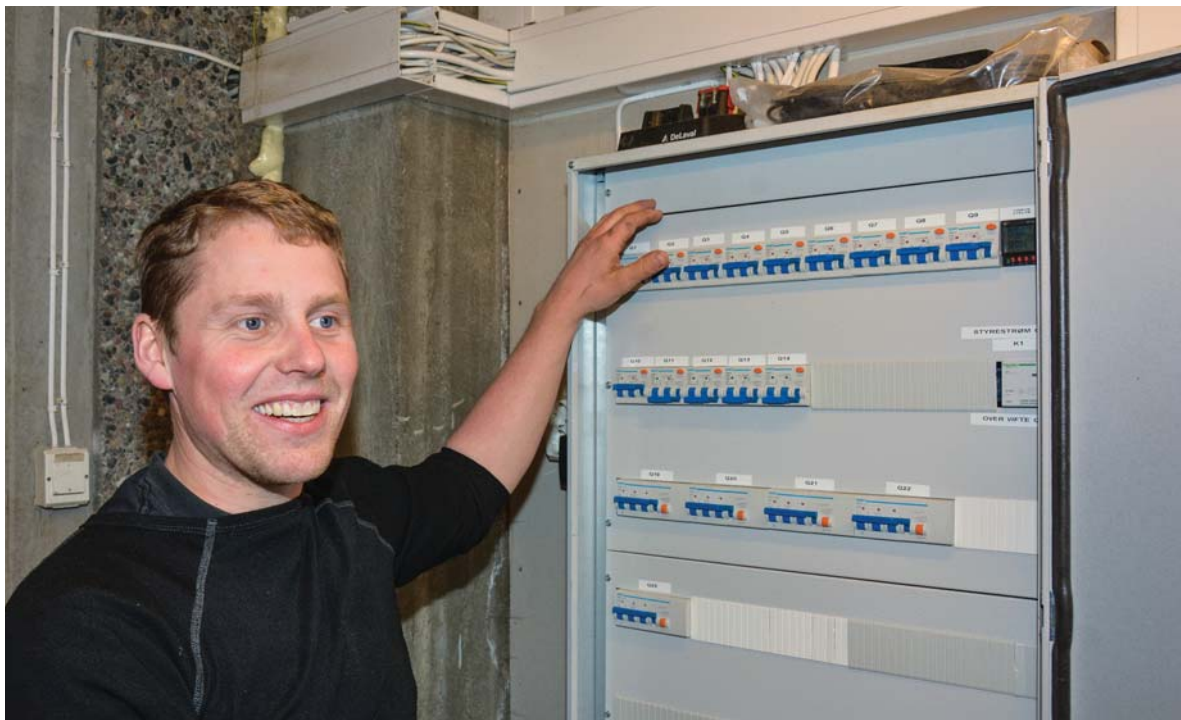
Ellitsyn avslørte manglende jording i det nye sikringsskapet – en graverende feil som kunne fått fatale konsekvenser.
