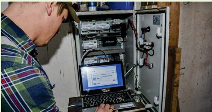
Fôringa styres fra en egen pc eller pc'en til robot/besetningsstyring på kontoret.
