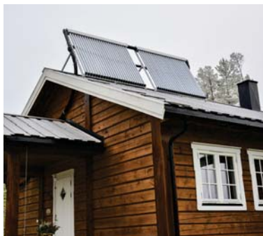
Solfangerpanelene på kårboligen produserte nesten 5 000 kilowattimer fra januar til midt i november.
