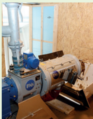
Gjødselseparatoren plassert i eget isolert hus. Væskefraksjonen går i rør til gjødselkum, mens den faste fraksjonen slippes ned til lager under bygget.
