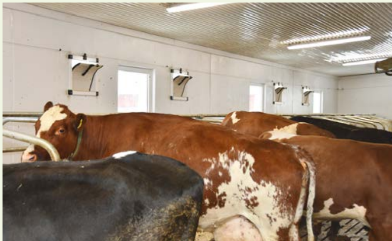
Første ventil på langveggen (ventilen lengst til høyre på bildet) er plassert for langt fra hjørne mot gavlvegg (ideelt skal første ventil være 1,5 meter fra hjørnet).
