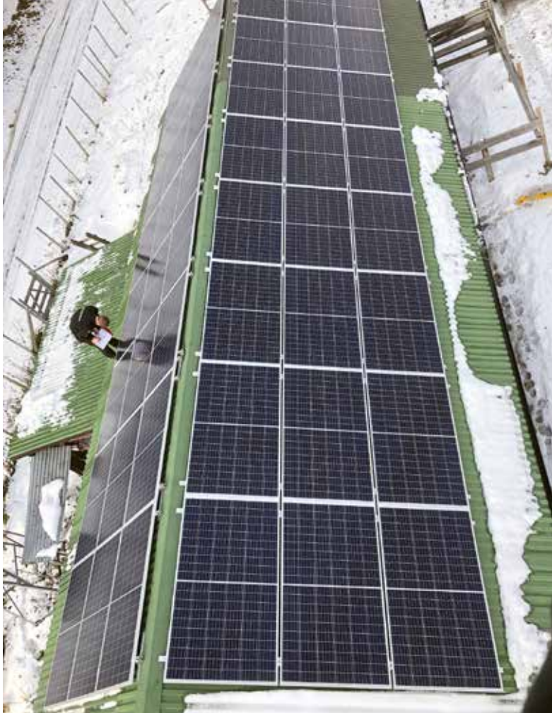
Solcellepaneler på seterfjøsset sørger for strømproduksjonen. Foto: EnergiPluss
