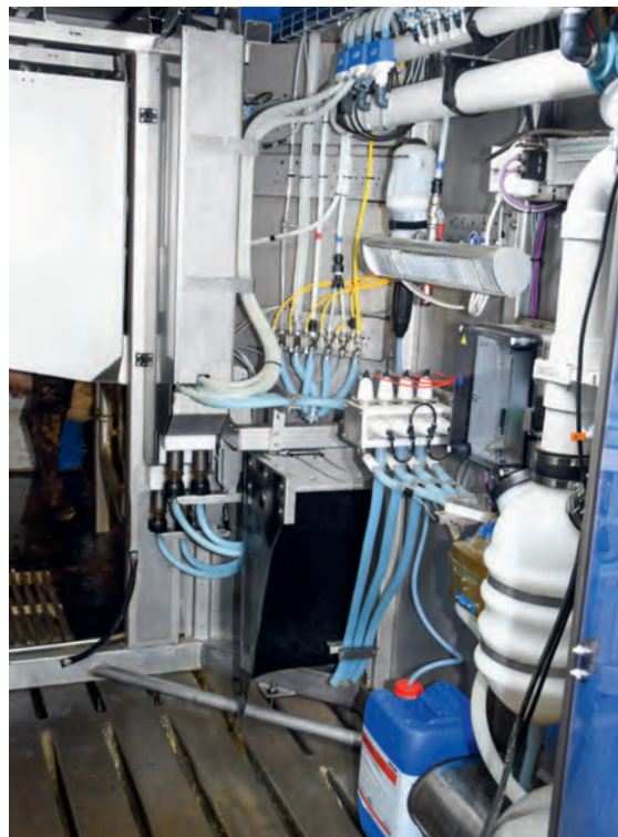
Teknisk rom der det meste ligger åpent. Manuell melking skjer her ved vanlig påsett av spenekoppene bakfra.
