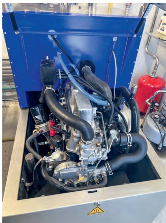
Motoren som driver generatoren er en Toyota Hiace dieselmotor.
