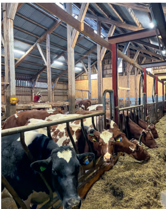
Uisolert trefjøs med innredning av tre. Frontene mot fôrbrettet har blitt skiftet ut.
