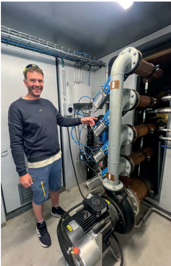
Ola Vaseng i driftsrommet. Det er mye teknikk knyttet til et biogassanlegg, men anlegget fungerer nå meget bra.
