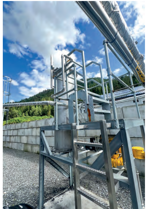
Sylinderen inneholder kull som fjerner hydrogensulfid fra gassen som ellers ville ødelegg motorene.
