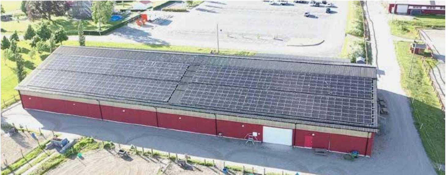
Ecosol har installert solcelleanlegg på fjøs ved Kalnes jordbruksskole.
